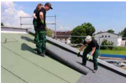
Die zu begrünende Dachfläche wird mit einer gemäß dem FLL-Verfahren auf Wurzelfestigkeit geprüften Dachabdichtungsbahn abgedichtet.
