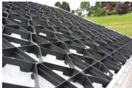
Nach Abdecken der Fläche mit der Wasserspeichermatte WSM 150 werden – beginnend von unten links – die Georaster®-Elemente verlegt.
