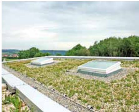
Das verwendete Substrat ist eine spezielle Mischung aus Kalksplitt, Lava und humosem Anteil.
