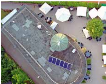
Das Dach des KETV als „nacktes“ Bitumendach vor der Neugestaltung zu einem Gründach.
