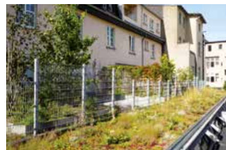
Nach dem abschließenden Montieren von Fallnet® SB 200-Rail steht den gesicherten Arbeiten im Bereich des Dachrandes nichts mehr im Wege.
