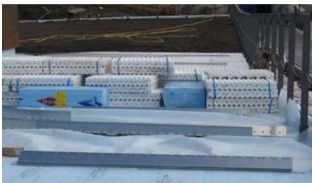
Auf die bereits verlegten Wärmedämmplatten werden die Floraset® FS 75 Elemente verlegt und mit Substrat überschüttet.
