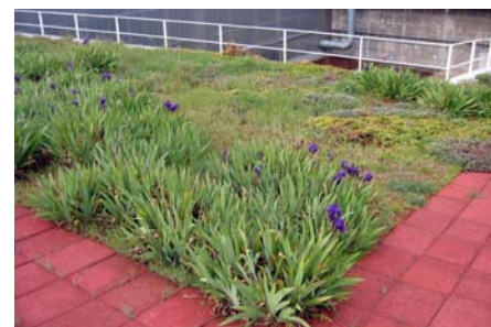
Um das Gründach Besuchern zeigen zu können, wurde eine ebenfalls begrünte Terrassenfläche vorgesehen.
