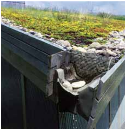
Abflussverzögerung einer extensiven Dachbegrünung.
