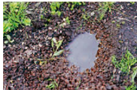
Die Dränfunktion dieser „Dachbegrünung“ ist offensichtlich unzureichend...
