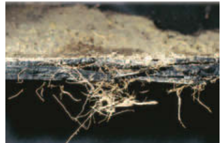
Eine von Wurzeln durchdrungene Bitumenabdichtung ohne Wurzelschutzausrüstung.
