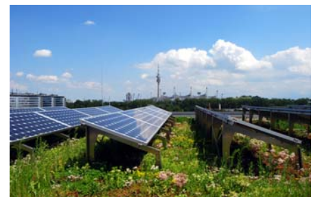
Da ein Gründach eine erheblich geringere Oberflächentemperatur aufweist als ein nacktes oder bekiestes Dach, bleibt auch das Photovoltaik-Modul über einem Gründach kühler und eine hohe Leistung somit erhalten.
