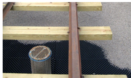
Unter den Schienen befindet sich ein Gründachaufbau mit verfüllten Floradrain®-Elementen als Dränschicht.
