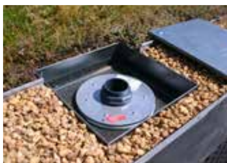
Das Drosselelement liegt geschützt unterhalb des Kontrollschachts und reguliert den langsamen Wasserabfluss. Es fungiert gleichzeitig als Überlauf.
