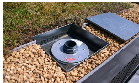
Das Retentions-Drossel-Set befindet sich über dem Dachablauf.
