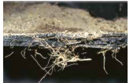
Eine von Wurzeln durchdrungene Bitumenabdichtung ohne Wurzelschutzausrüstung.
