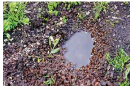
Die Dränfunktion dieser „Dachbegrünung“ ist offensichtlich unzureichend...
