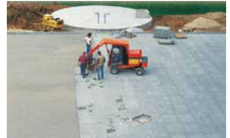
Bei entsprechend großen Belagsflächen kann sowohl die Pflasterverlegung als auch das Aufbringen einer Asphaltdecke maschinell erfolgen.
