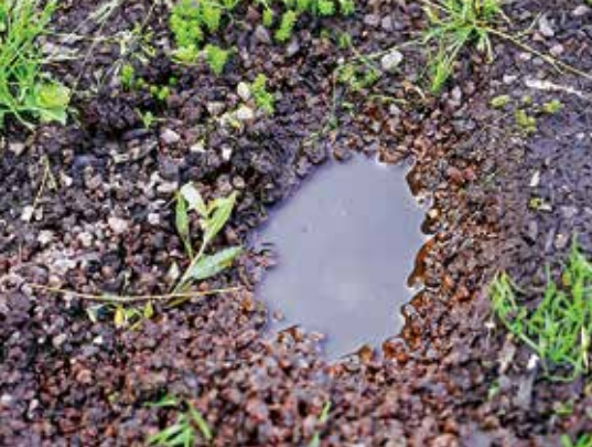
Die Drainfunktion dieser „Dachbegrünung“ ist offensichtlich unzureichend.
