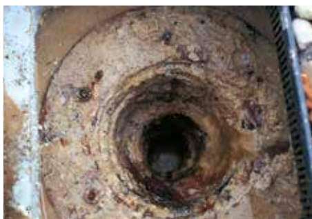
Schutzschichten aus Beton bergen das Risiko der Versinterung der Dachabläufe. Mit Schutzlagen aus Synthesefasern oder Kautschuk kann dies verhindert werden.
