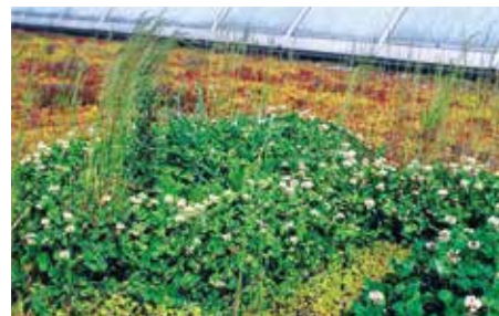
Kleearten können sich in einer extensiven Begrünung einnisten – sie sollten rechtzeitig entfernt werden.
