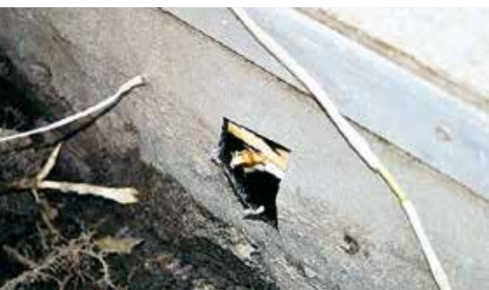
Bereits durch die Abdichtung gewachsene Bambusrhizome
