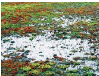
Ein extremes Beispiel – aber auch geringere Pfützenhöhen sind bereits kritisch!
