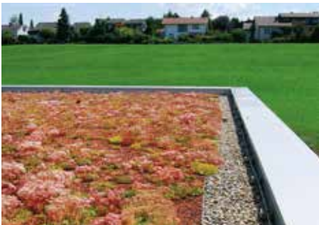
Sicherheits- und Brandschutzstreifen sollten regelmäßig gesäubert und von Bewuchs freigehalten werden.
