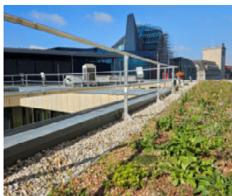
Das Fallnet® ASG-Arbeitsschutzgelenk wurde als Kollektivschutz zur Absicherung bei Wartungsarbeiten am Dachrand zum darunterliegenden Innenhof installiert.
